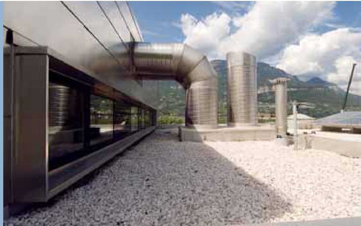
Presa d'aria esterna per l'impianti di ventilazione controllata
