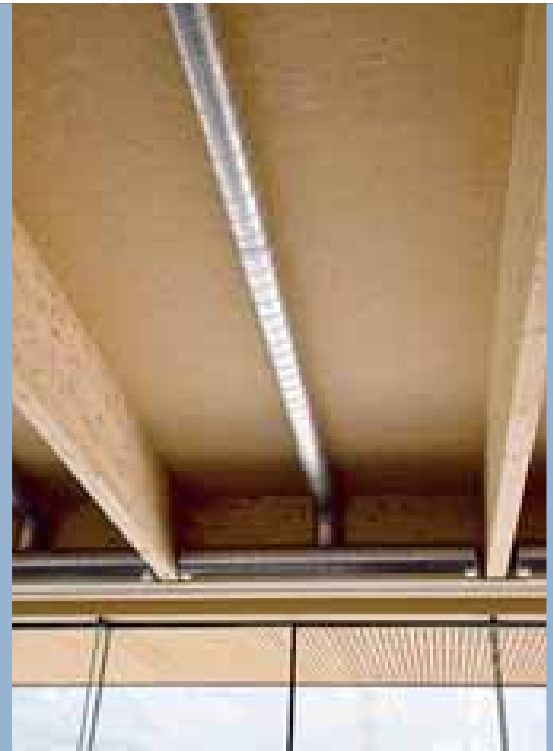
Condotta di ventilazione
