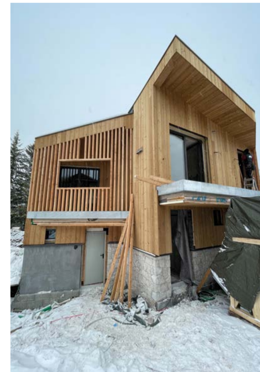
La scala in legno con il passaggio impianti a parete e la struttura dell'edificio quasi ultimata.
